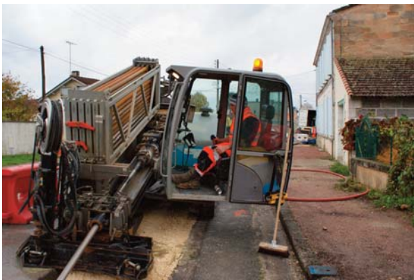
Machine destinée à réaliser le fonçage pour passer la canalisation d'eau potable sous les ouvrages d'eaux pluviales au lieu-dit Reyraud du Moulin.
